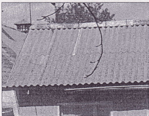
Fot.1 Płyty azbestowo-cementowe faliste
