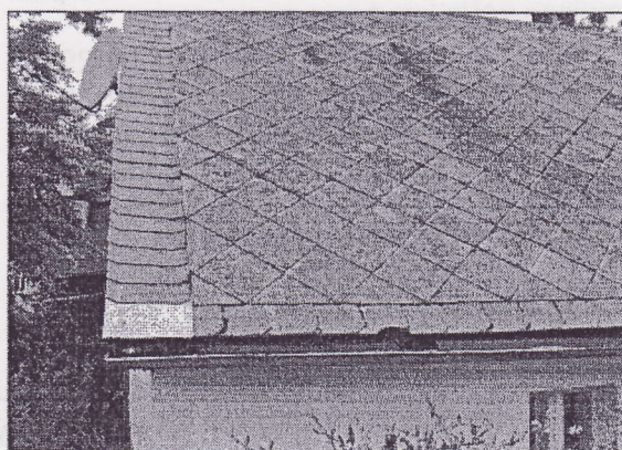
Fot. 2 Płyty azbestowo-cementowe płaskie
